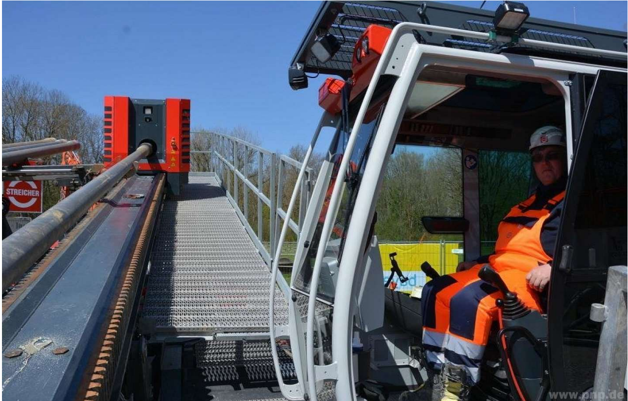
Marco Mörs ist Geräteführer. Er steuert die innovative Spülbohranlage der Firma Streicher. Dank des elektrischen Antriebs ist sie selbst bei Hochbetrieb kaum zu hören. –Fotos: Huber
